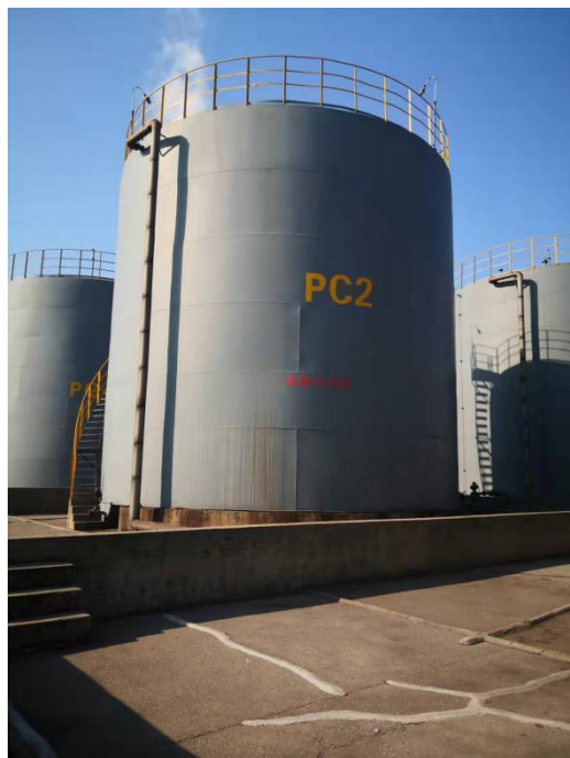
碳酸丙烯酯储罐
