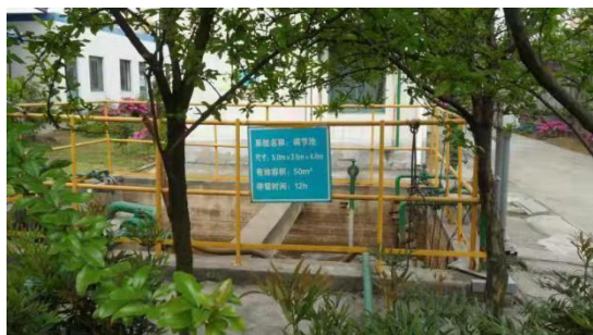
污水处理站调节池
