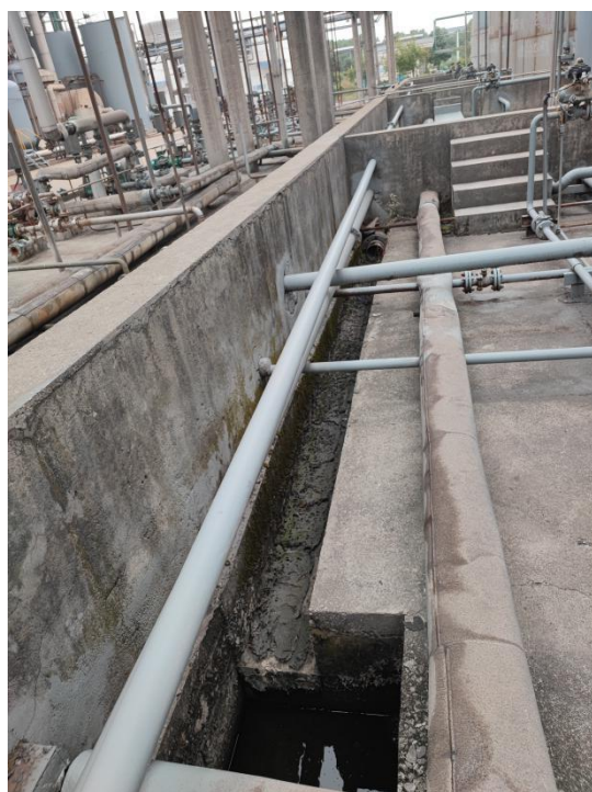
罐区地面冲洗水和初期雨水收集槽
