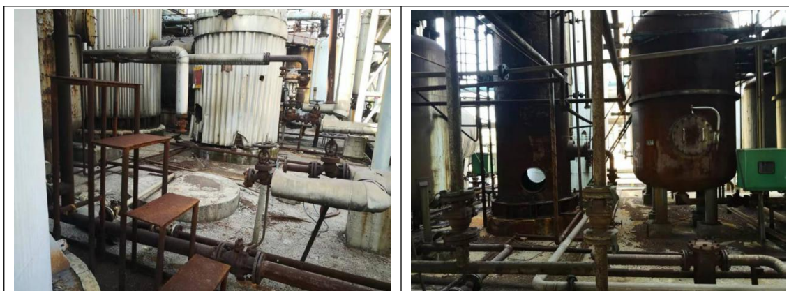
DMC 一期装置设备全部停用且年久失修已无法生产，设备设施未拆除
