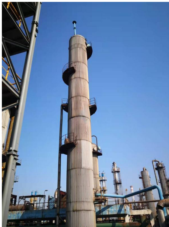
新增的一套尾气冷凝吸收塔及排放口
