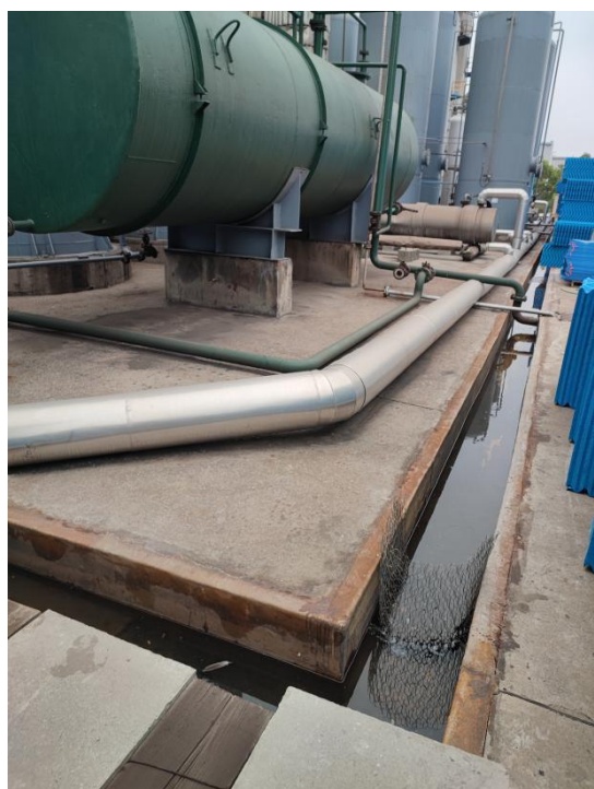
生产区地面冲洗水和初期雨水收集槽
